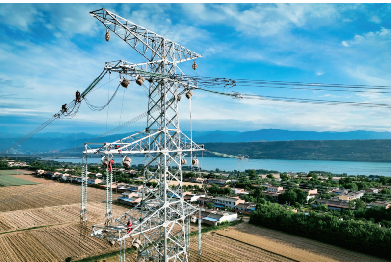
陕北—安徽±800千伏特高压直流输电工程
